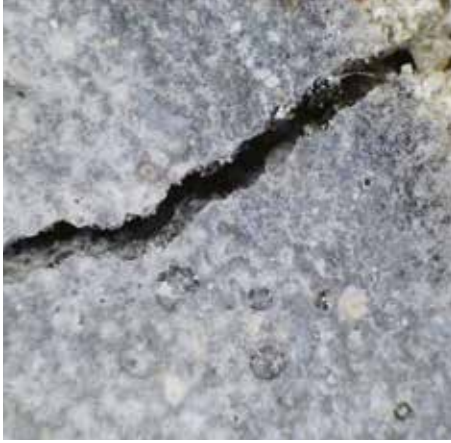
AQUAFIX uygulanmamış beton kırış (0,5 mm çatlak)
